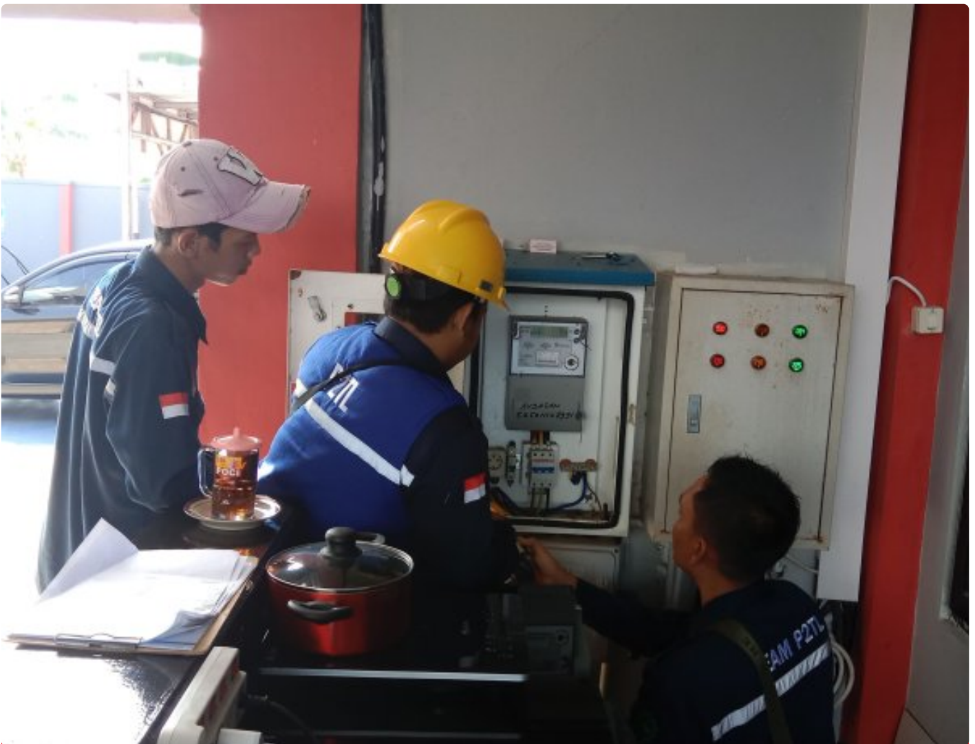
Pegawai PLN Cilacap memeriksa panel listrik di kantor Rupbasan Cilacap
